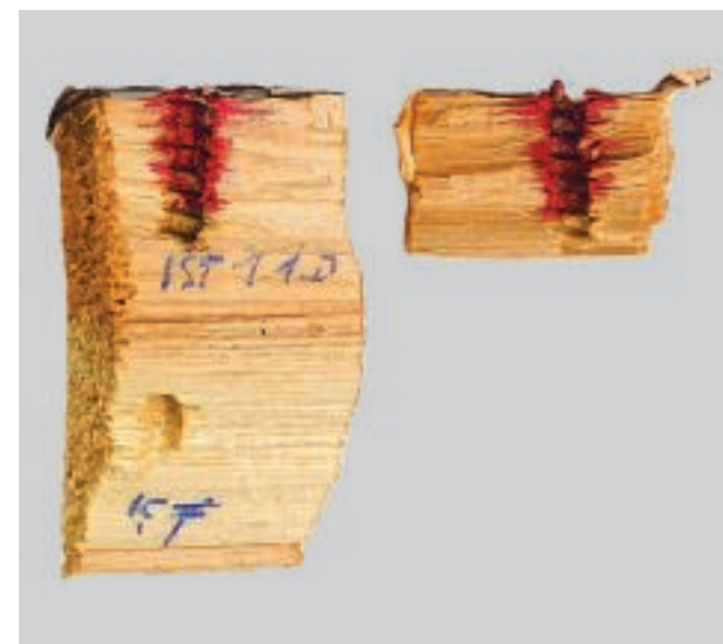
Feuchtigkeitsschaden im Schraubkanal
